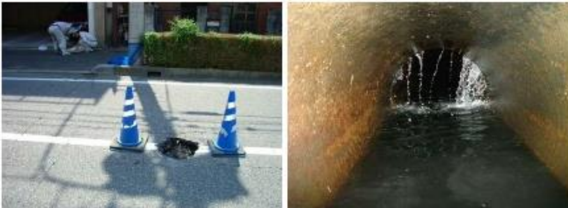
《過去に蕨市内で発生した下水道管の老朽化による陥没や浸入水》
